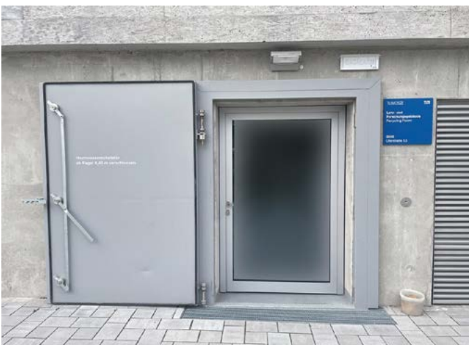
Abb. 2: Die Hochwasserschutztüren werden ab einen Pegel von 6,40 m verschlossen.
