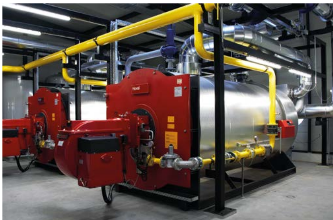
Die beiden Gaskessel am Standort Christian-Weißmantel-Straße mit jeweils 5 MW thermischer Leistung
