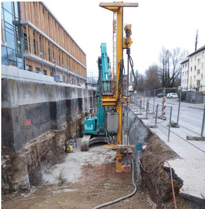
Abb. 15: Bodenverbesserung für das Zugangsbauwerk. Einblick in das Bestandstragsystem der Hochwasserschutzwand: Bohrpfähle und Schwarzabdichtung für die einseitige Böschung.
