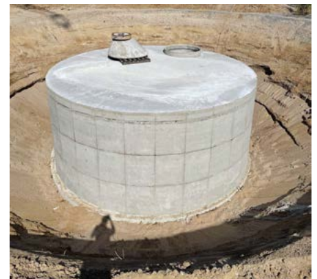
Sowohl im ersten als auch im zweiten Bauabschnitt plante Vollack einen Eis-Latentwärmespeicher. Der sorgt für eine effiziente Wärme- und Kälteversorgung. Bild: Vollack Gruppe
