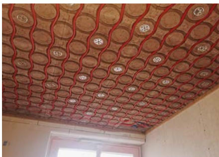
Wasserführende Schlauchleitungen in den Lehmmodule heizen und kühlen von oben. Bild: Spreepan Projekt UG
